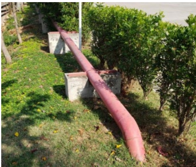
Rede principal de incêndio danificada.
