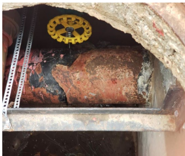
Oxidação na tubulação.
