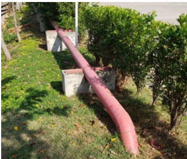
Rede principal de incêndio danificada.
