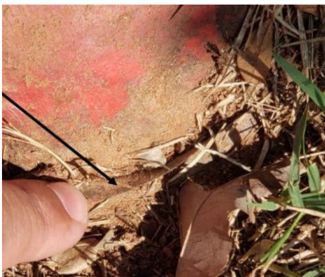
Falta de aderência na fita anticorrosiva.
